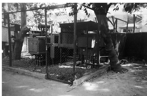
Рис. С36: Подстанция наружной установки без корпуса
