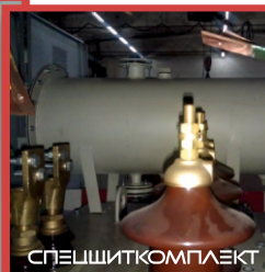
СПЕЦШИТКОМПЛЕКТ Латунные гайки и шайбы на шпильках трансформатора
