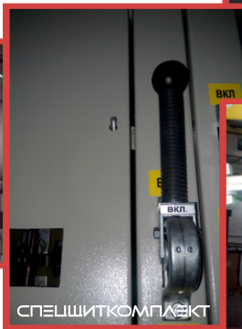
СПЕЦШИТКОМПЛЕКТ Пломбировка трансформаторных ячеек ЩО-90
